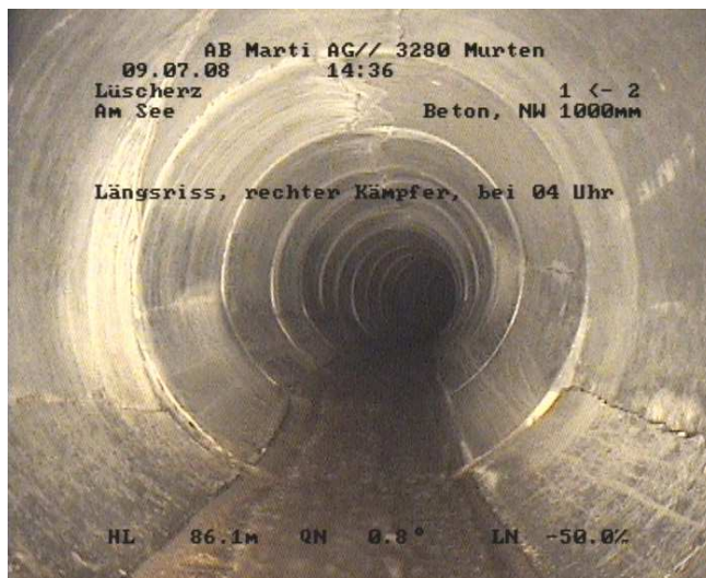
Abbildung 10: Zustand best. Bachleitung, 75–128 m
